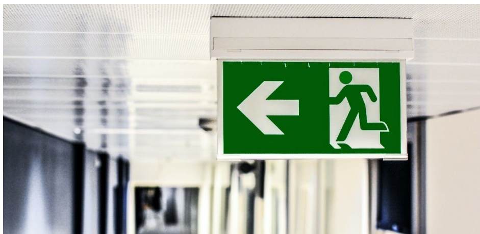
Abbildung 10: Beleuchtetes Rettungswegkennzeichen an der Decke [8]
